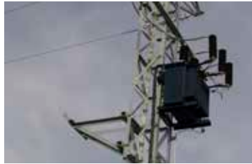
Transformadores e interruptores con aceite
