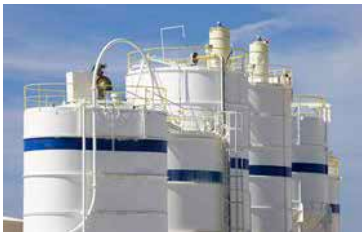
Almacenamiento de líquidos inflamables en tanques
