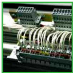
Armarios eléctricos y subestaciones
